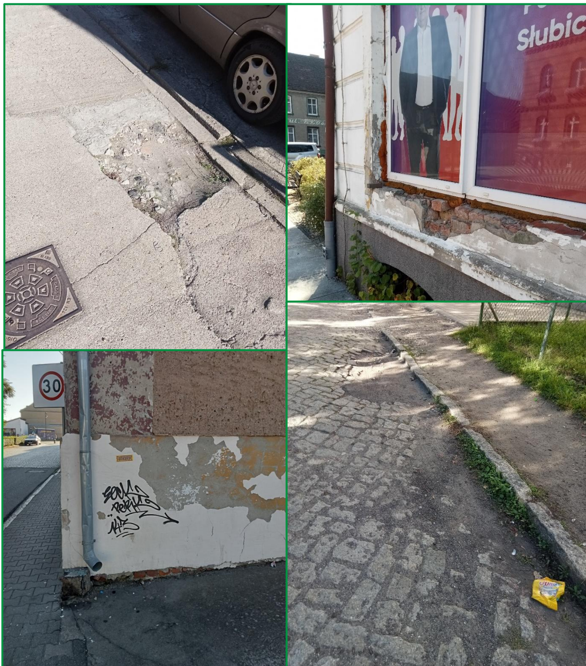
Rycina 21 Przykłady przestrzeni wymagających poprawy stanu technicznego na obszarze rewitalizacji
