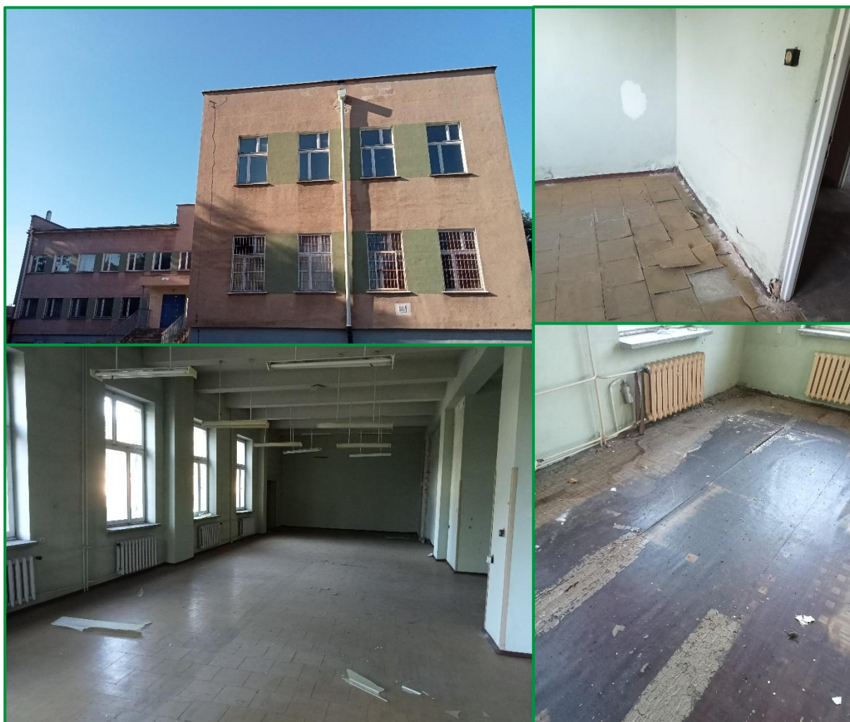
Rycina 22 Stan techniczny budynku przy ul. Wojska Polskiego 25A w Rzepinie
